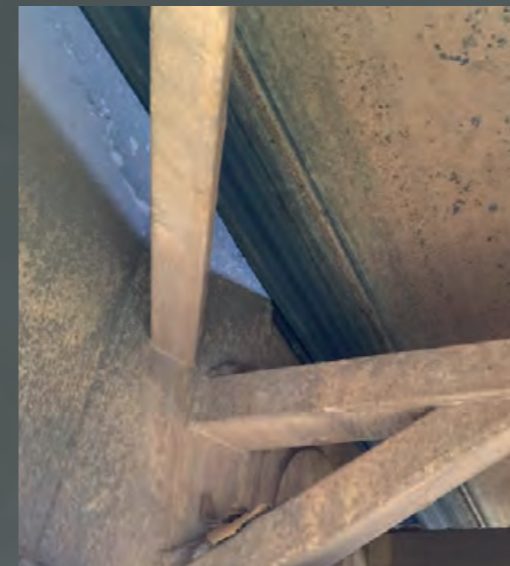
Décentrage de la bande : La bande transporteuse coupe déjà la structure porteuse
