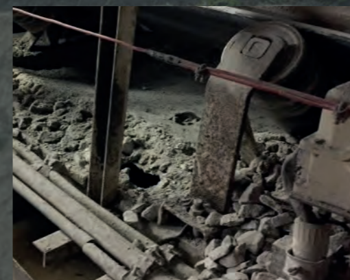
Encrassement dû une mauvaise étanchéité des bandes de transfert
