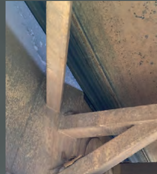
Marcha oblicua de la banda: La banda transportadora sufre cortes en la estructura portante
